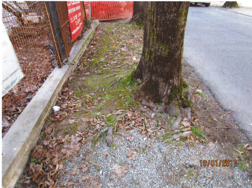
FOTO 4. Vista esterna del passaggio pedonale non pavimentato
