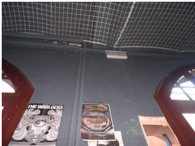
PARTICOLARE DELLA RETE DI PROTEZIONE IN SALA
