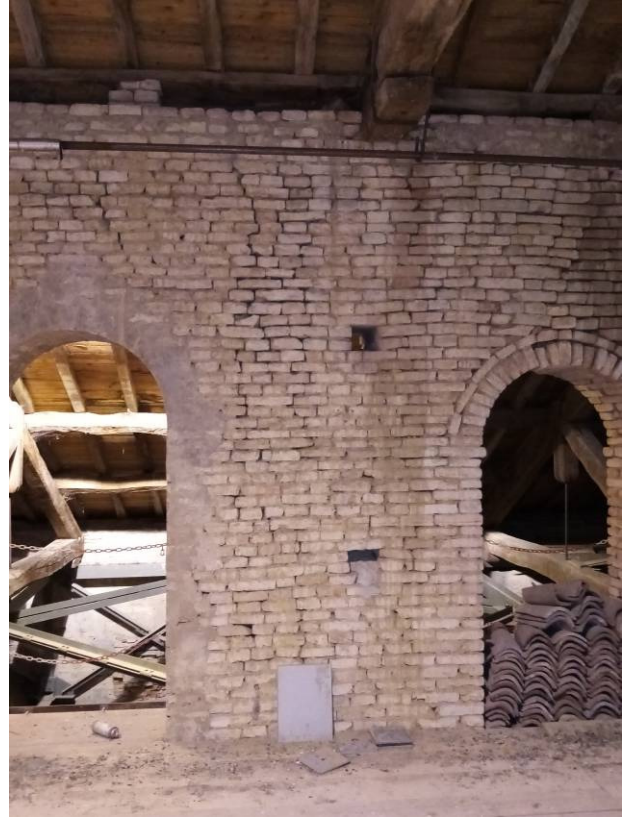
Fig. 19 – Dettaglio del degrado della muratura
