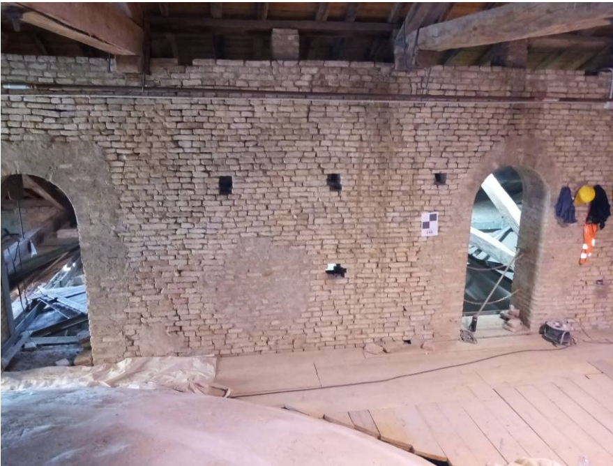
Fig. 20 – La muratura caratterizzata dal degrado dei giunti di malta e dalle buche puntaie aperte
